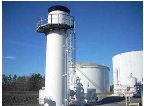
Vapour Combustion Units (VCUs)
